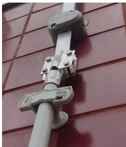
Detalhe da transição entre descida de barra chata e condutor CUI com conector Tel 722
