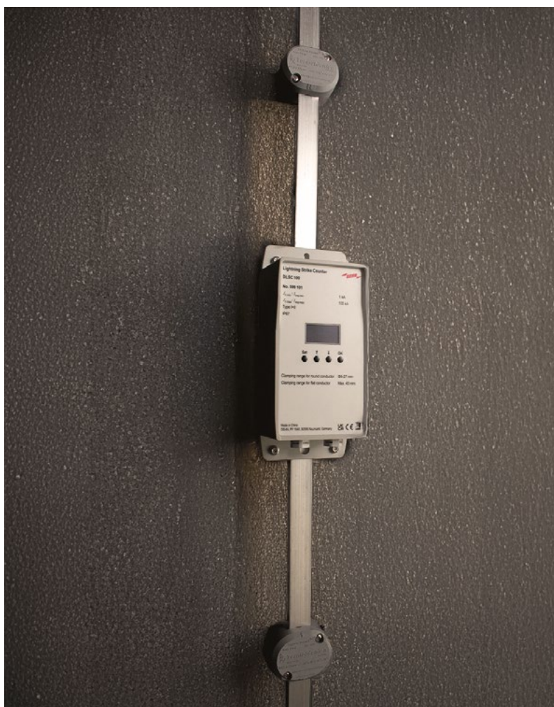
Exemplo de instalação do Contador de descargas atmosféricas em Barra chata de alumínio com Fixatel
