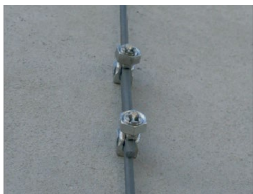
Utilização da Rebar como condutor externo.
